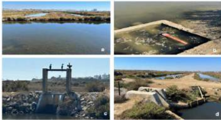
Figura 8. Sistema de tanques (a); válvula de retenção (b); comportas (c, d).
